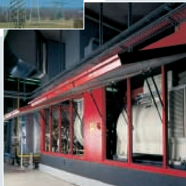
moderne Gasturbine (Kraft-Wärme-Kopplung): 85% Brennstoffausnutzungsgrad
