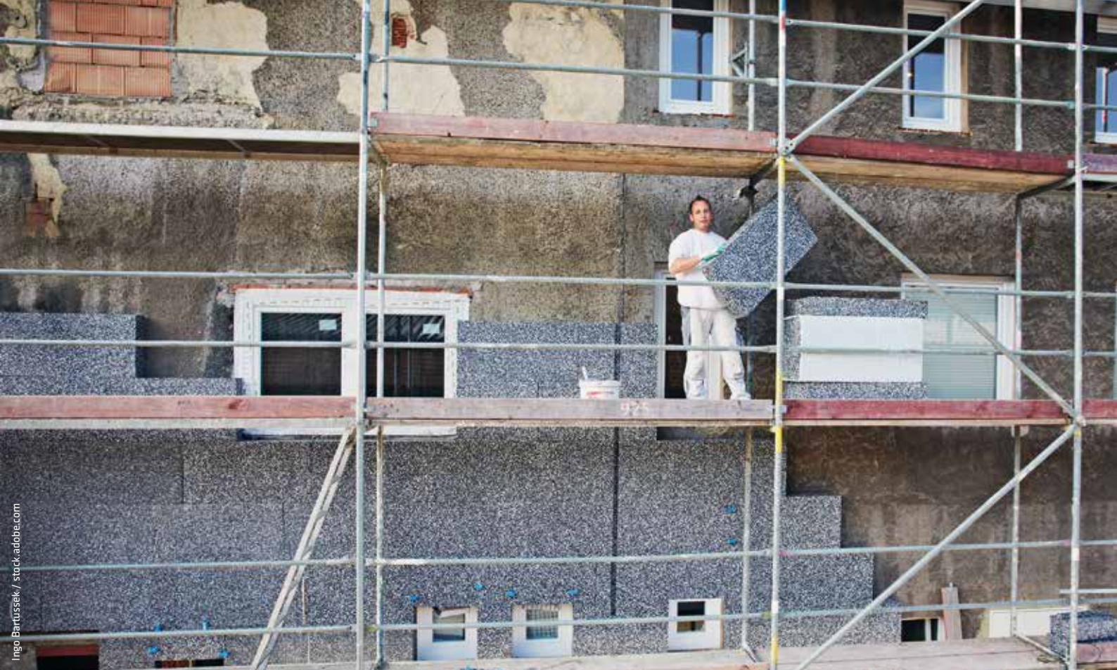
Hier lohnt sich Dämmen: Neben dem Dach sind die Außenwände die größte Energieschleuder im Haus.
