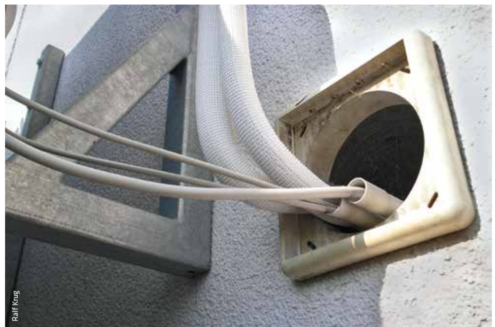
Nutzung der Verbrennungsluftleitung zur Anbindung der Wärmepumpe.
