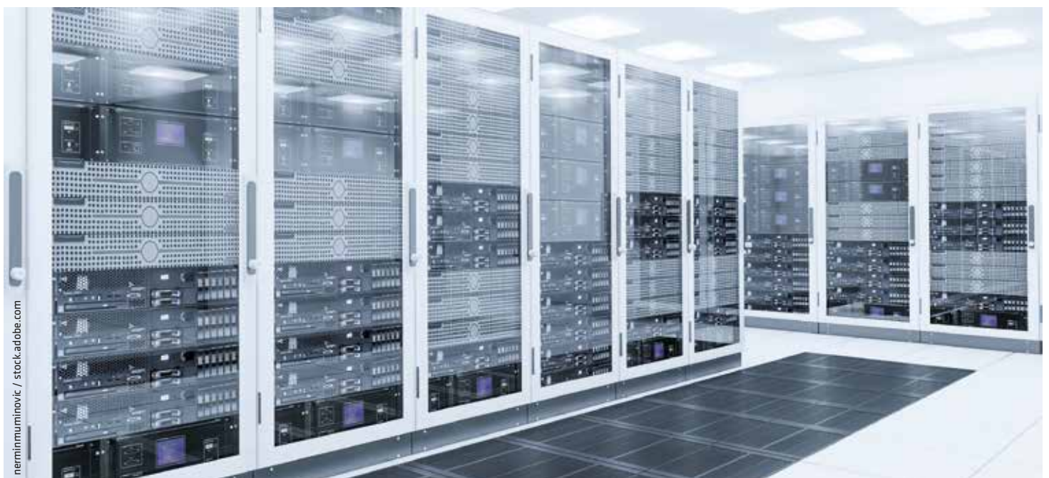
Wachsende Datenvolumen lassen neue Rechenzentren entstehen. Deren Abwärme bleibt allzu oft ungenutzt.
