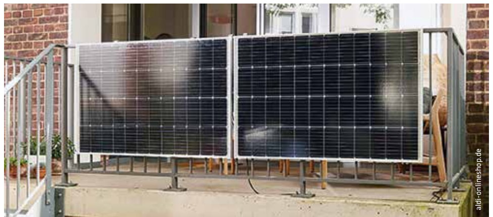
Angebot auf der Webseite von Aldi: das 600 W „Plug & Play“ Balkon-Kraftwerk SP 175/350 Wp für 469 Euro. Garantie drei Jahre
