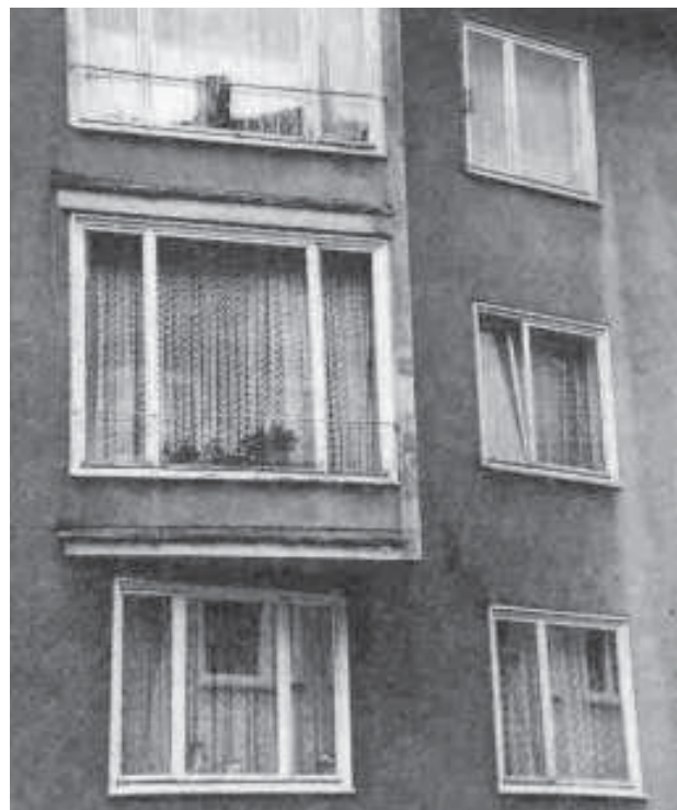
Vermeidbare Energieverluste entstehen Jahr für Jahr durch diese einscheibenverglasten Fenster.
